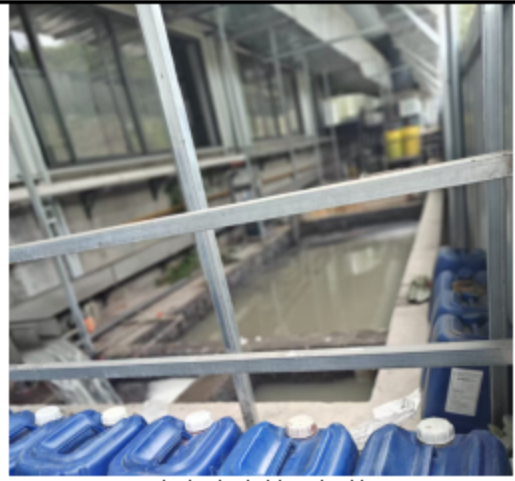
生产废水处理设施
