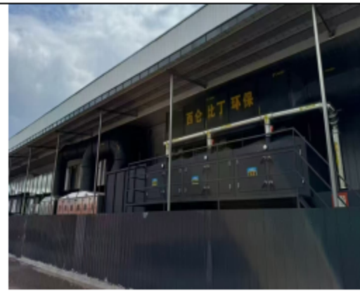
废气处理系统
